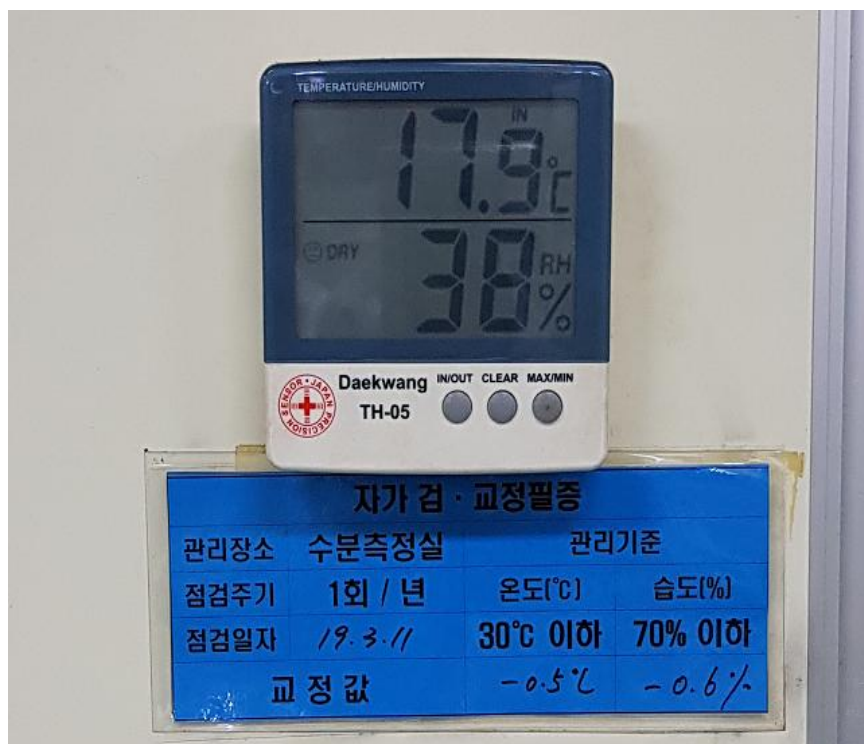
습도기준 및 습도계 설치
